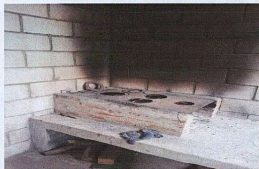
Foto 2: Sustitución de estufa rural en mal estado, con su respectiva chimenea.
